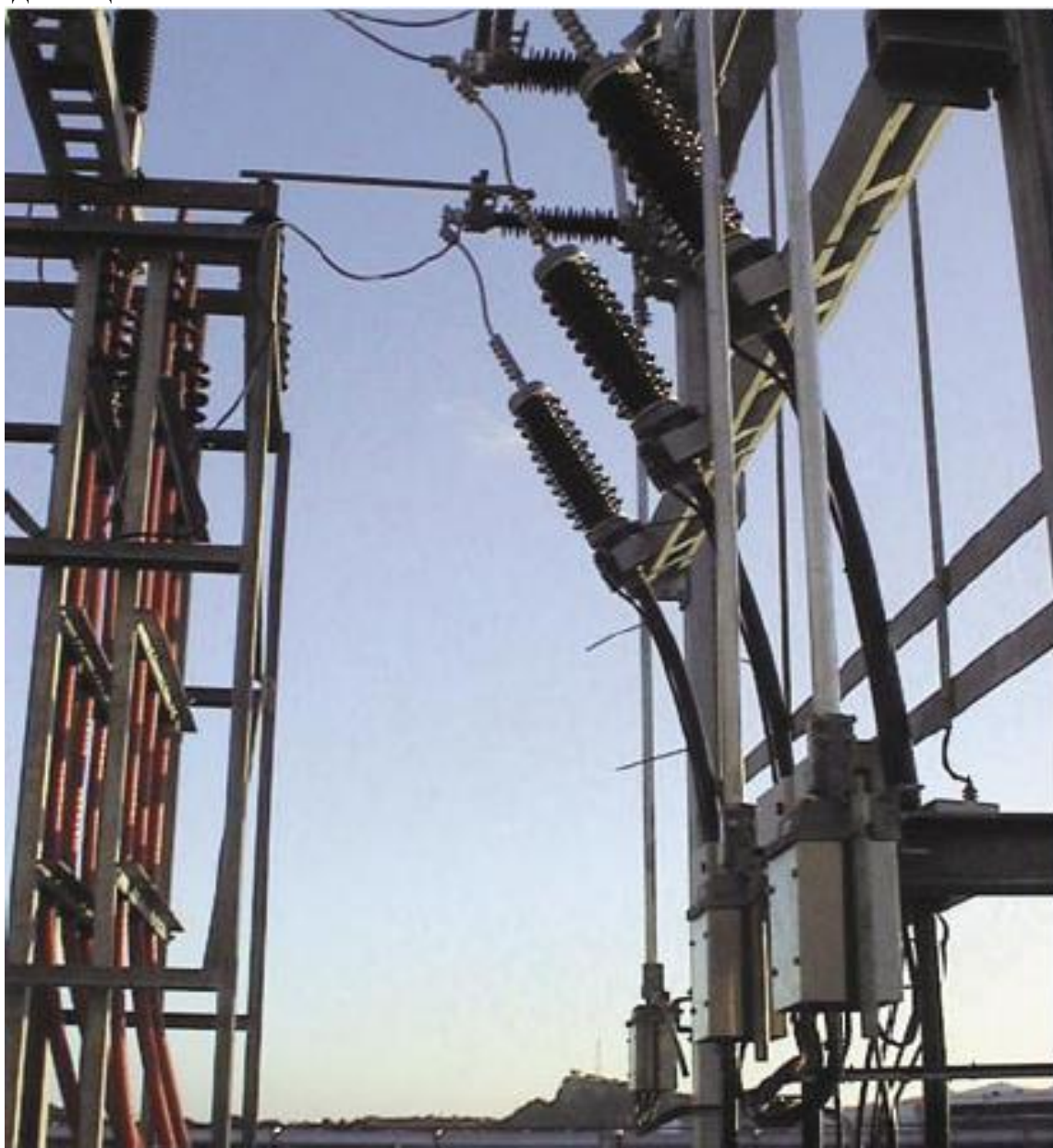
Рис. 5.30. Переход КЛ-110 кВ на ОРУ-110 кВ подстанции
