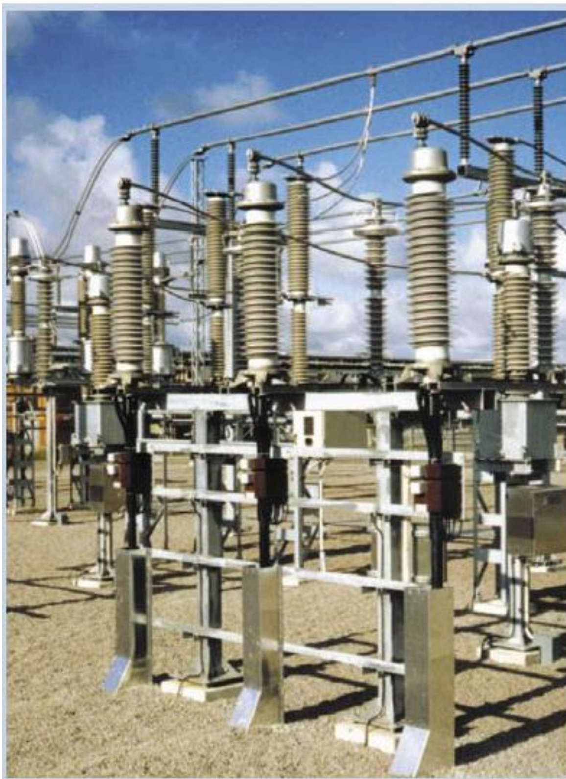
Рис. 5.31. Переход КЛ-110 кВ на ОРУ-110 кВ подстанции
