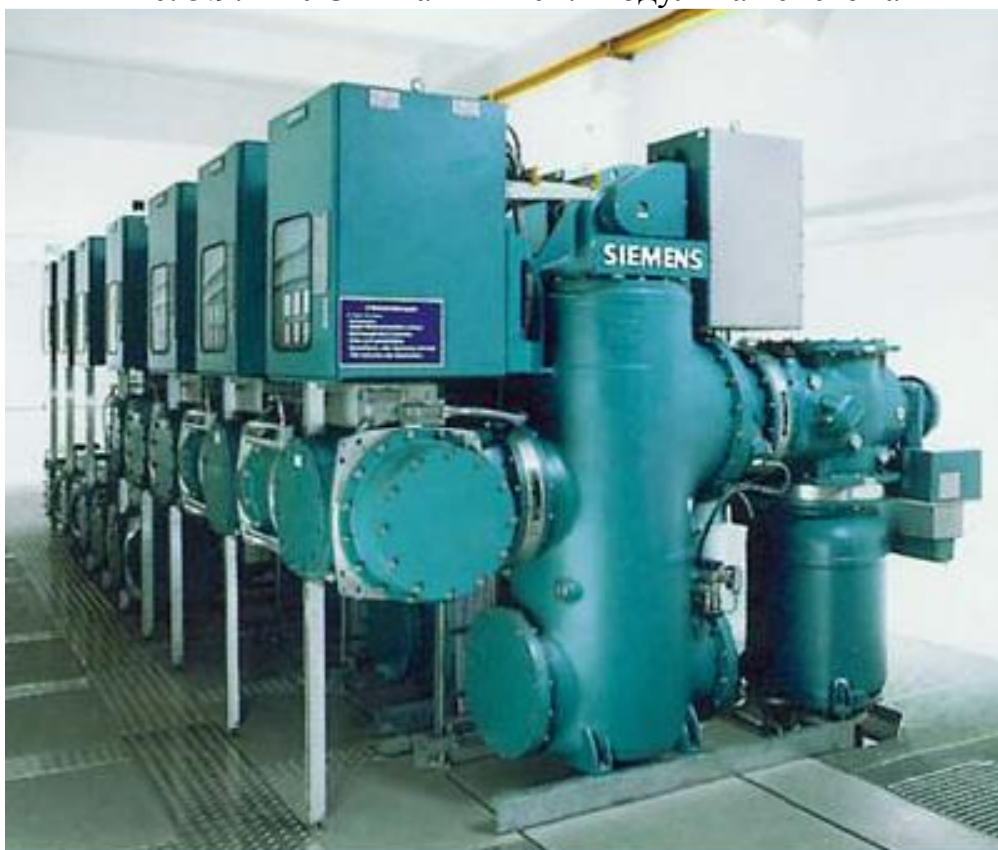
Рис. 5.10. Внешний вид ЗРУ-110 кВ фирмы SIEMENS с использованием элегазовых ячеек КРУЭ
