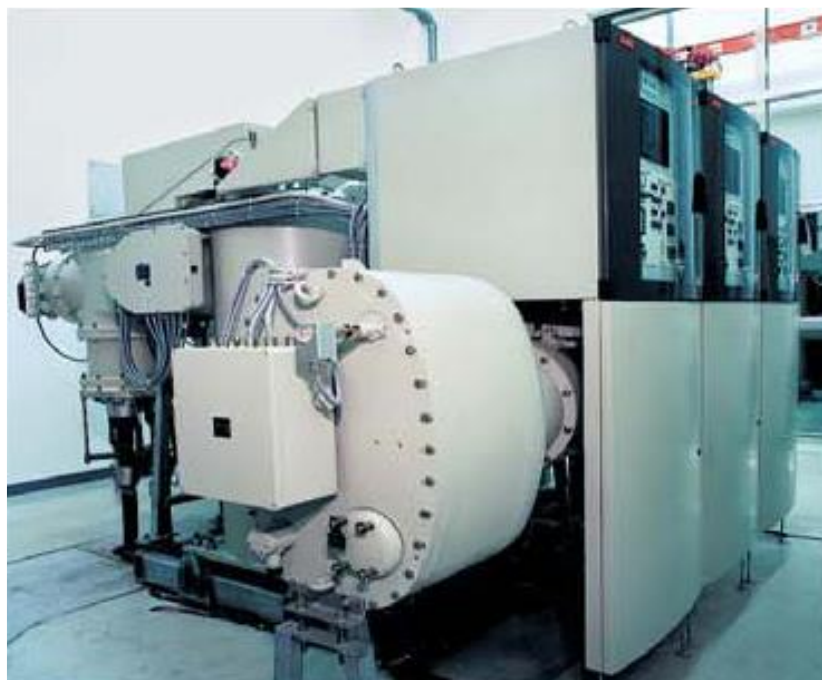
Рис. 5.17. Трансформатор напряжения со стороны шин
