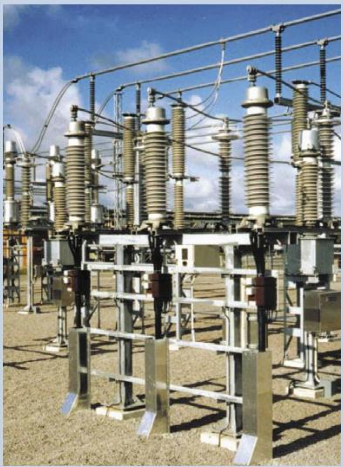
Рис. 5.38. Переход КЛ-110 кВ на ОРУ-110 кВ подстанции
