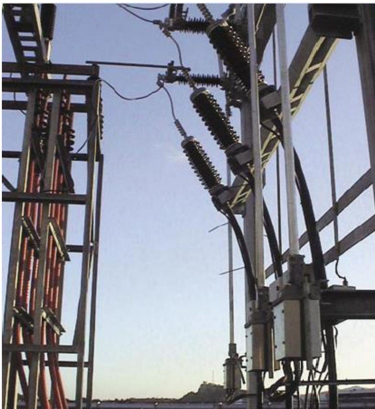
Рис. 5.37. Переход КЛ-110 кВ на ОРУ-110 кВ подстанции
